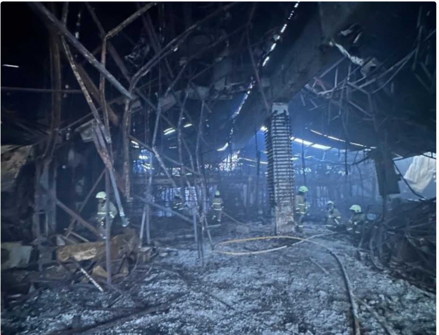
Glodok Plaza yang Hangus Terbakar
